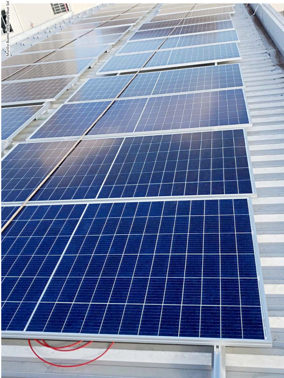
Os painéis de captação de energia solar foram instalados no telhado do prédio central do CEAC
